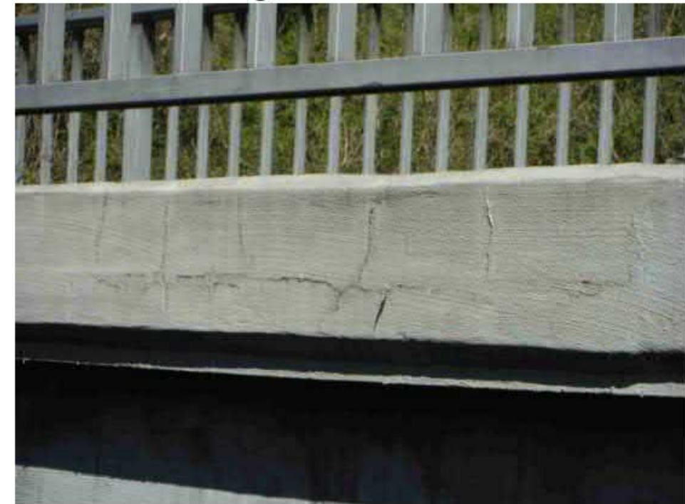
GESIMS RECHTS RISSIG
