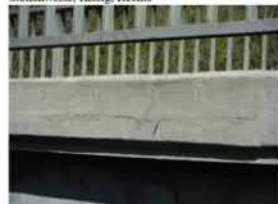
GESIMS RECHTS RISSIG
