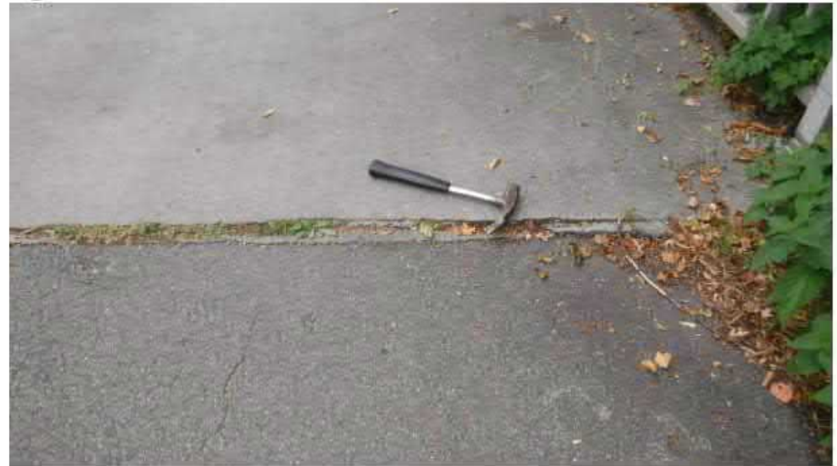
BELAG ABGESACKT STOLPERGEFAHR
